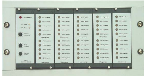
Anzeigepanel für die BSK-Zustandsmeldungen
